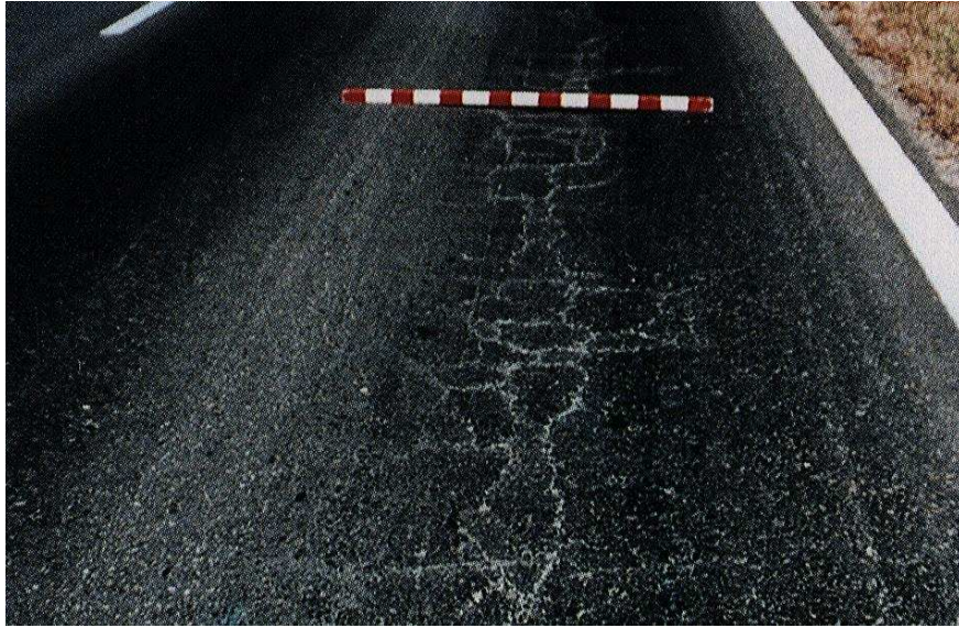
FIG. 1.3 : Fissuration d'une chaussée bitumineuse par fatigue (LCPC, 1998).
