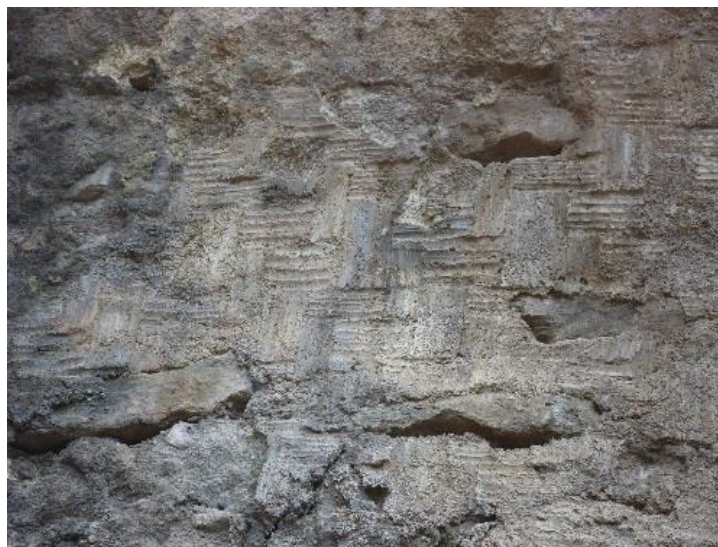
Figure 374 Traces de coffrage sur la voûte de la nef
