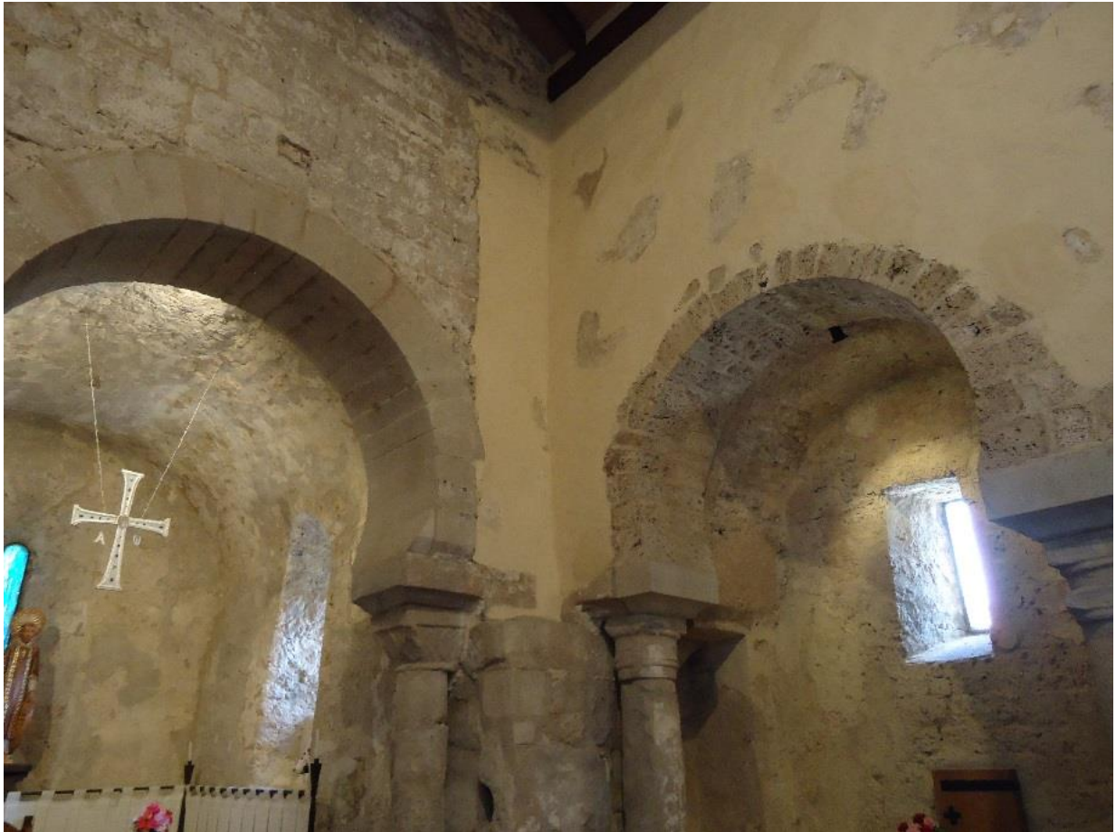
Figure 67 Vue du chevet avec son arc triomphal restauré et du bras sud du transept
