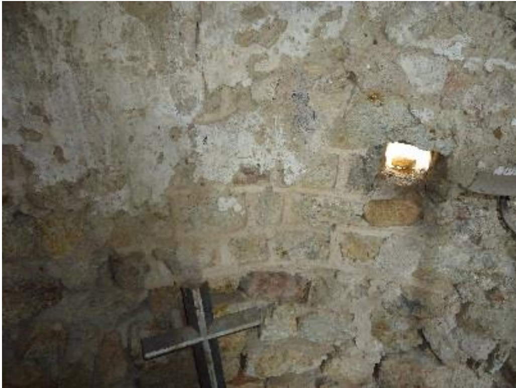
Figure 54 Joints rubannés sur le mur intérieur de l'abside
