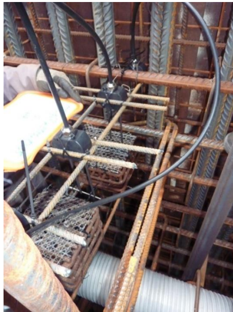
Figure 46. Capteurs TDR mis en place dans la levée 11 de l'enceinte de Flamanville 3.
