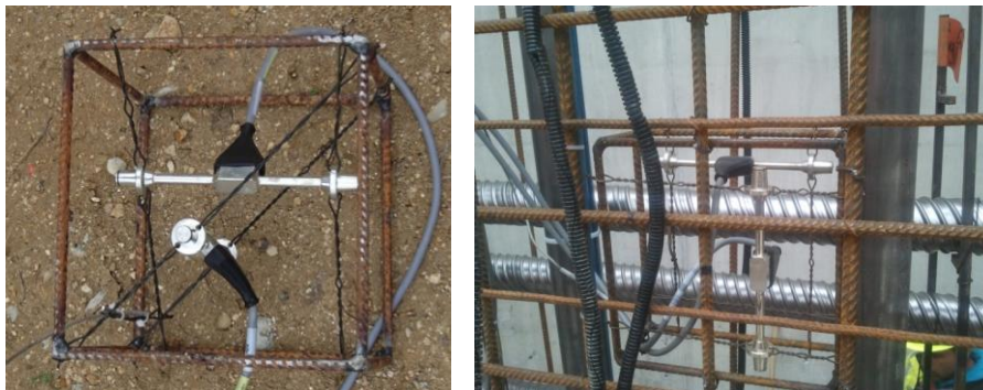
Figure 19. Capteurs de déformation à corde vibrante conditionné dans leur « cage » (à gauche) pour être placé dans le ferrailage (à droite) (© EDF).
