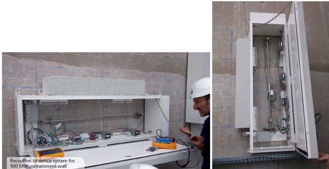
Figure 21. Capteurs de parement installés sur site (© EDF).
