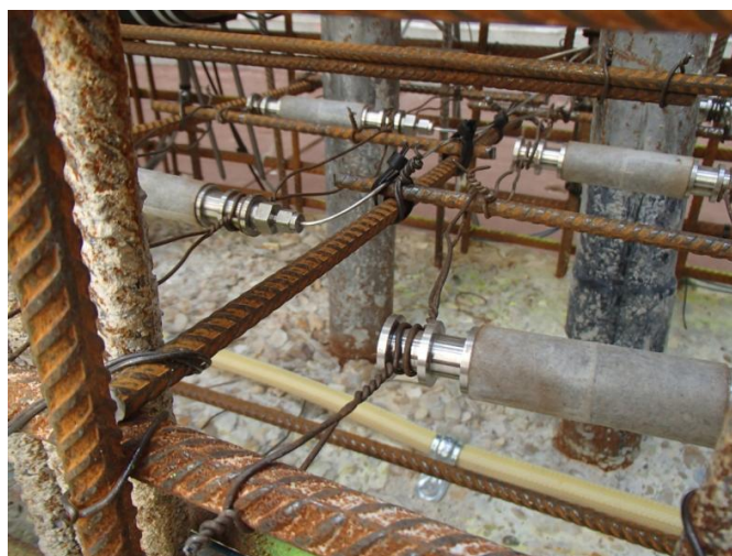
Figure 41. Capteurs de technologie « pulse decay » mis en place avant le bétonnage © EDF.
