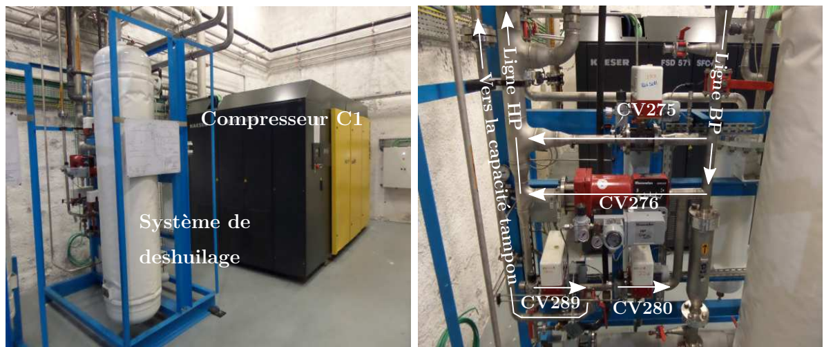
FIGURE 3.8 – À gauche, photo du compresseur C1 et de son système de déshuilage. À droite, photo des vannes de la zone chaude.
