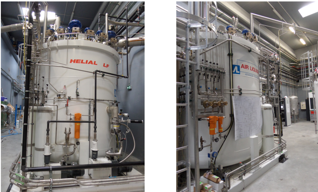
FIGURE 3.4 – Photos de la boîte froide de SPIRAL2
