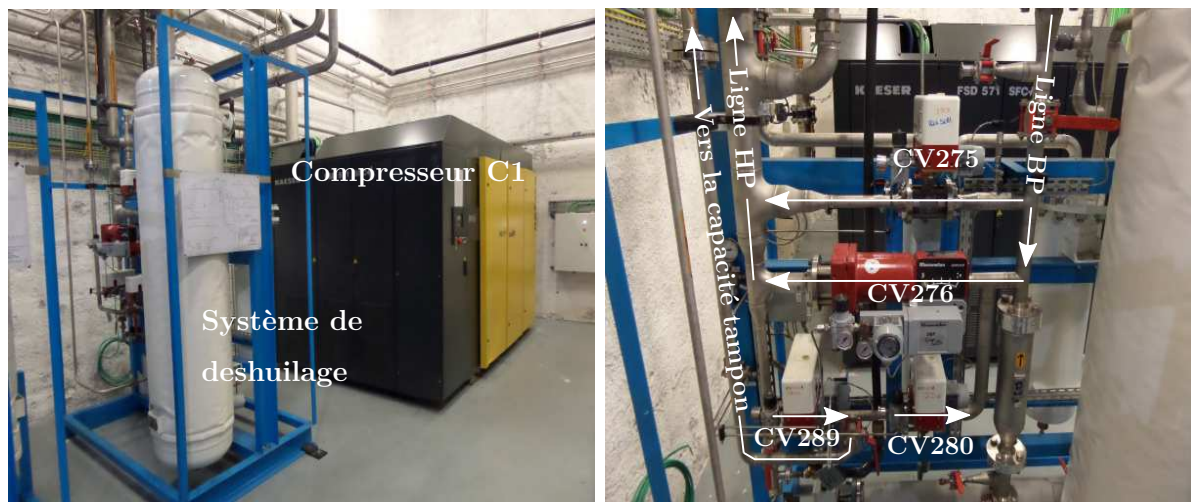
FIGURE 3.8 – À gauche, photo du compresseur C1 et de son système de déshuilage. À droite, photo des vannes de la zone chaude.
