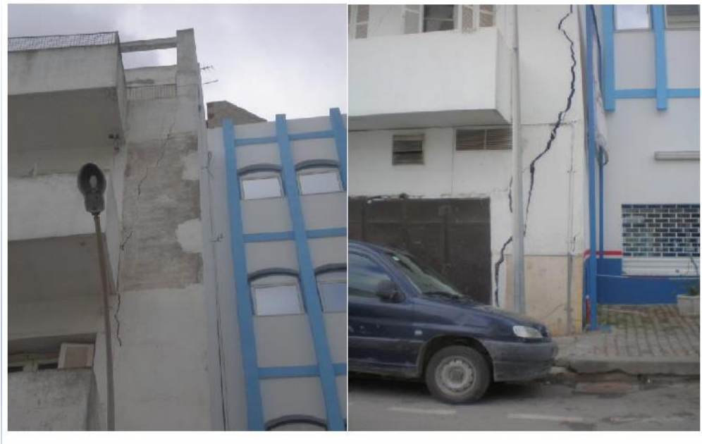
Figure 158 - Tassement d'un bâtiment identifiée dans le centre - ville de Tunis (source, Bouassida et Klai, 2016)
