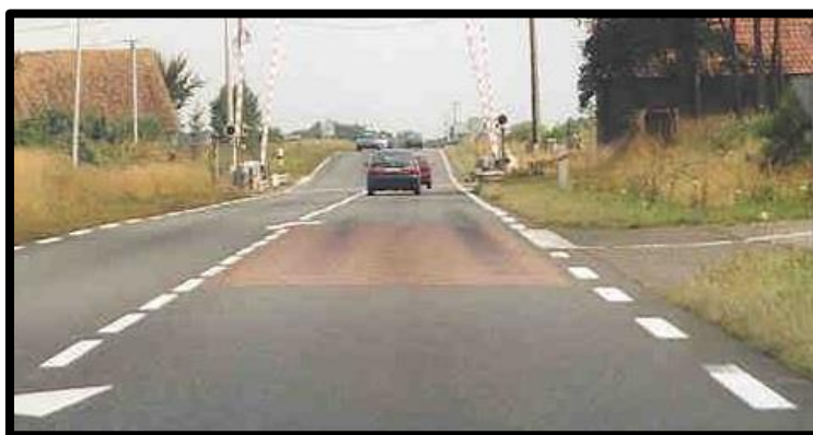
Figure 6.25 : Dépôts de gomme sur revêtement bitumineux coloré Photographie : Michèle St-Jacques
