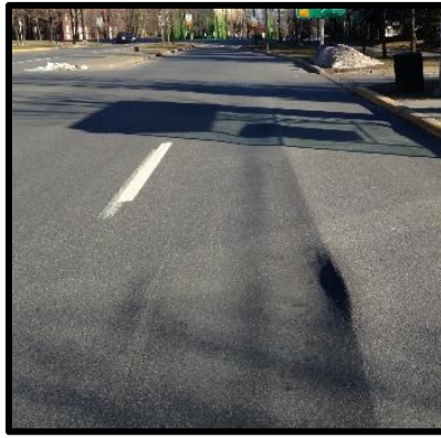
Figure 11.9 : Présence d'ornières sur la chaussée
