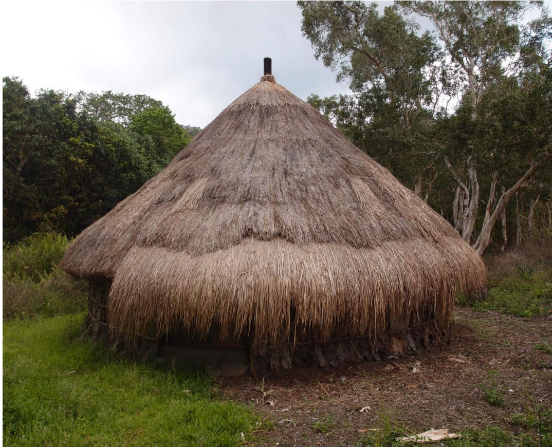
Photo n°8 : Une case en cours de rénovation. En raison des difficultés à trouver de la paille, la couverture du toit n'a pas été complètement renouvelée, seuls les endroits très abîmés ont été rebouchés avec de la paille neuve.- Tribu de Tiouaé, photo de l'auteure, 24.10.2013.
