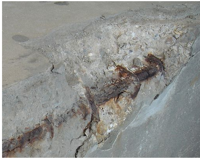
FIGURE 1 – Illustration de l'éclatement du béton armé dû à la réaction de carbonatation (source : MADe – CC-BY-SA, https://commons.wikimedia.org/wiki/File:Betոnrot_Hippodroom.JPG ).
