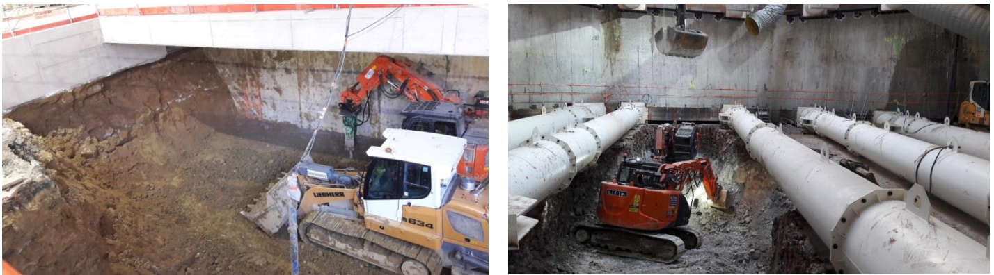
Figure 3-10 : Phases de terrassement en dessous du génie civil et en dessous des lits de butons
