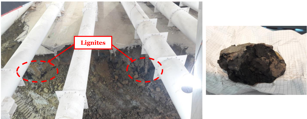
Figure 3-21 : Présence de lignites au toit de l'Argile
