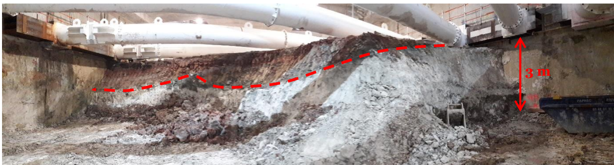
Figure 3-25 : Transition non horizontale entre les Argiles Plastiques et les Marnes de Meudon pendant la phase de terrassement P6 44,8 m NGF
