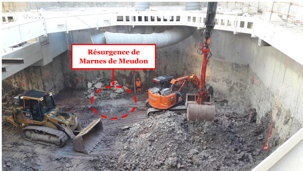
Figure 3-24 : Résurgence des Marnes de Meudon à la fin du terrassement P5 50 m NGF
