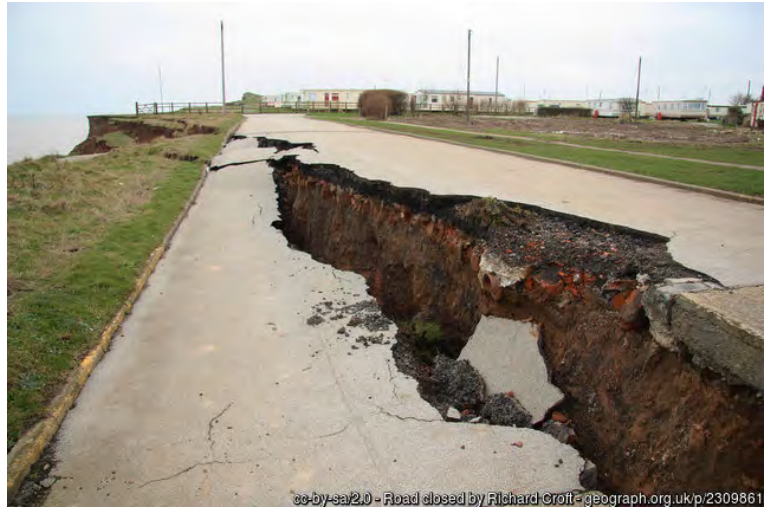
FIGURE 1.6 – Effondrement de falaise affectant une route à Aldbrough, Yorkshire UK
