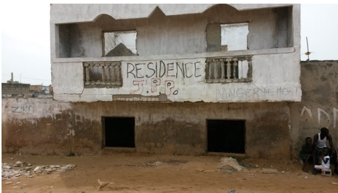
Photo 13 : Rez-de-chaussée de Maison complètement enseveli sous le coup des remblais à Djeddah Thiaroye Kao
