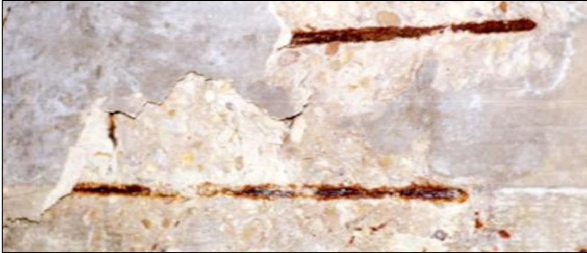
Figure II. 1 : Délamination et éclatement du béton [5]
