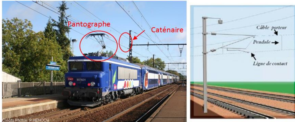
Figure 2: Une caténaire est composée de câbles porteurs en bronze ou en aluminium, de ligne de contact et de câbles conducteurs en cuivre
