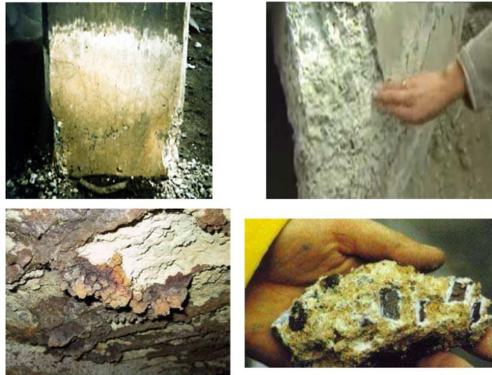
Figure 9. Bétons dégradés par les sulfates (El Hachem, 2010)
