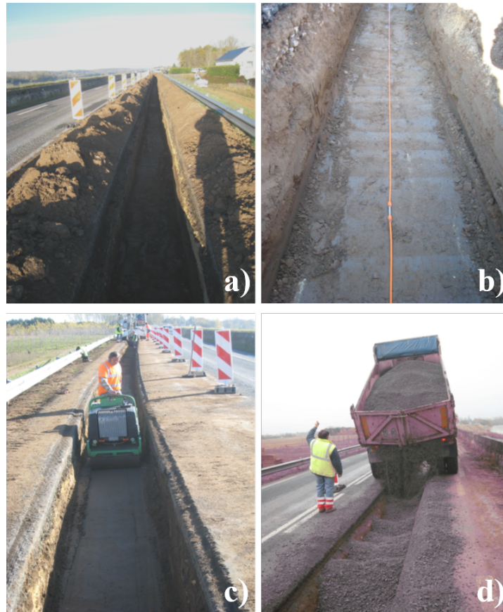
FIGURE V.4 – a) Réalisation de la tranchée côté val, b) mise en place des électrodes, c) compactage du remblai et d) mise en place de la couche de forme (photo côté Loire). Modifié d’après Hupin and Hervé (2009).
