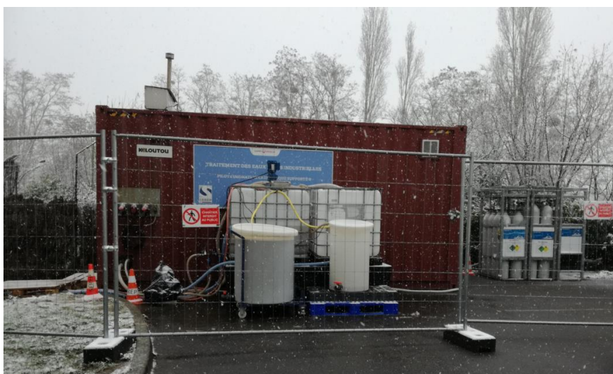
Figure 50 : Pilote et son unité mobile sur le site du CHU (Photo : SEREP-Technavox).
