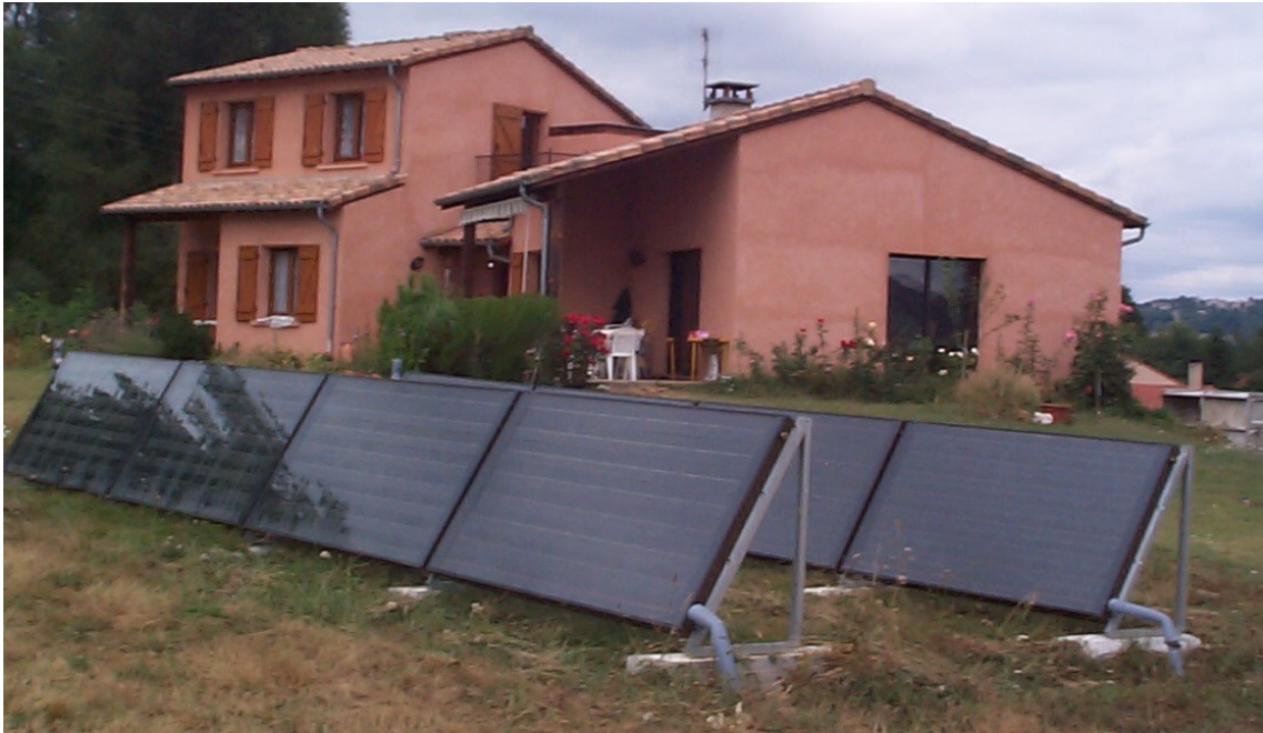
FIGURE 2.4 – Cas 2 : Photographie de la maison et des panneaux solaires.
