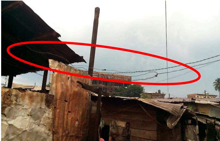
Photo 26 : Vue des câbles de distribution illégale de l'électricité à Elig-Edzoa © Djatcheu, août 2015
