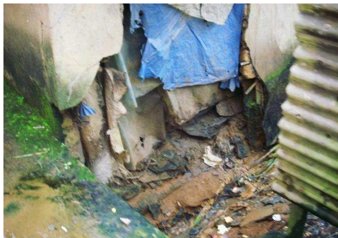
Photo 15 : Vue d'une partie du mur d'une habitation complètement ouverte sous l'effet de l'humidité corrosive à Melen
