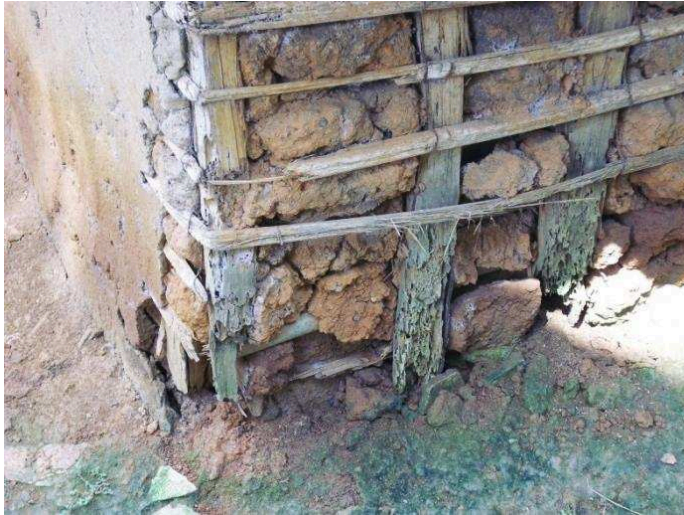
Photo 14 : Vue du pourrissement des piquets dans un bas-fond à Nlongkak
