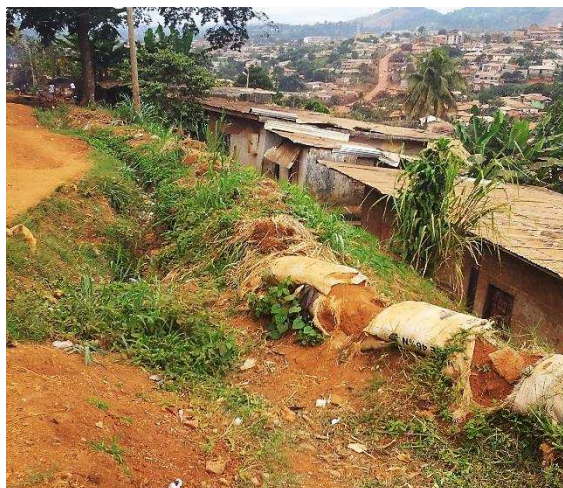
Photo 93 : Vue des sacs remplis de terre et empilés les uns sur les autres en amont des habitations à Oyom-Abang
