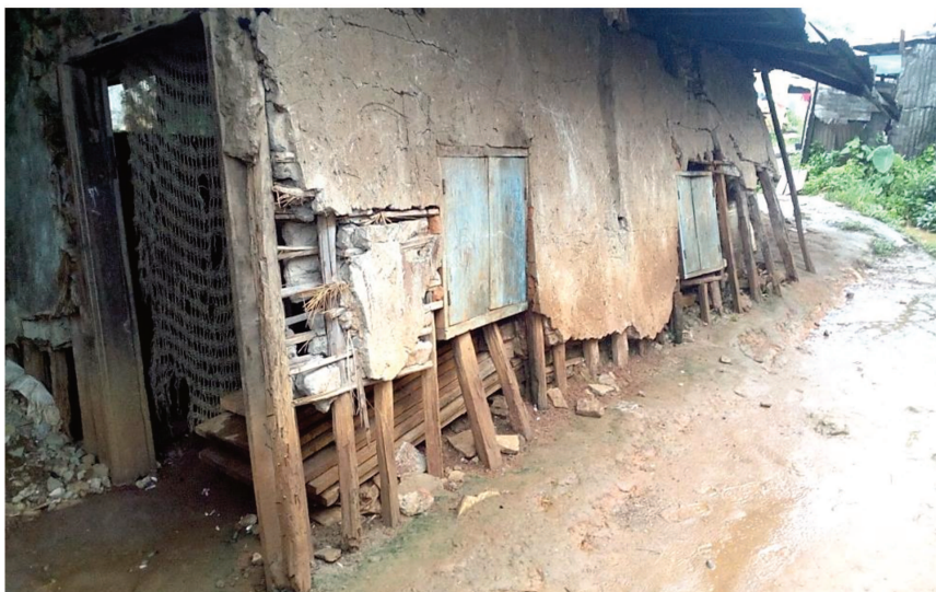
Photo 7 : Vue d'une maison en potopoto crépi à Elig-Edzoa et dont le niveau de dégradation surpasse tout commentaire © Djatcheu, octobre 2015
