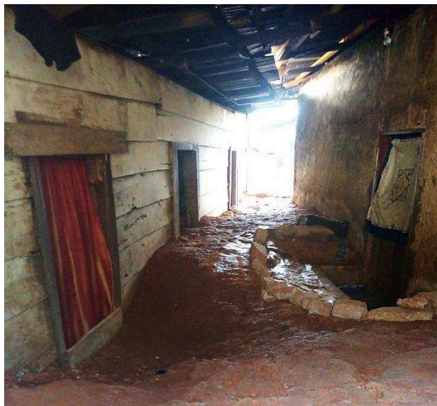
Photo 87 : Vue des maisons dont les entrées ont été remblayés plusieurs fois à Elig-Edzoa
