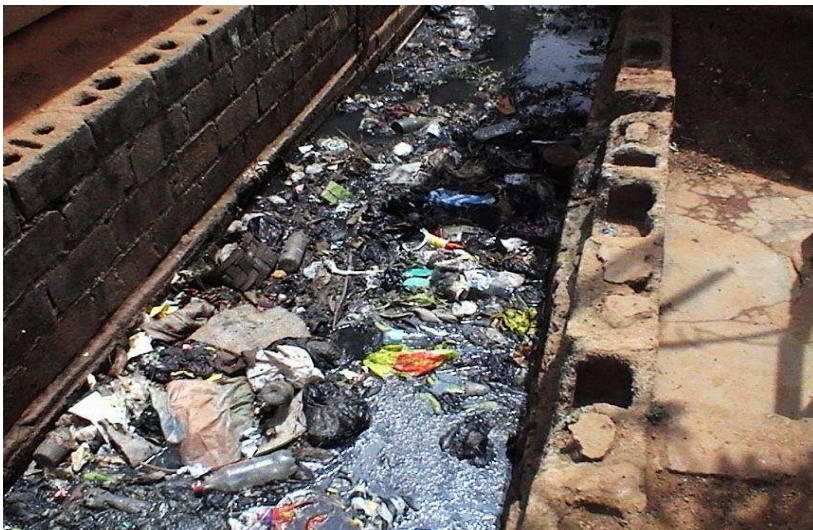
Photo 35 : Vue d'un cours d'eau encombré par les déchets solides à Nlongkak
