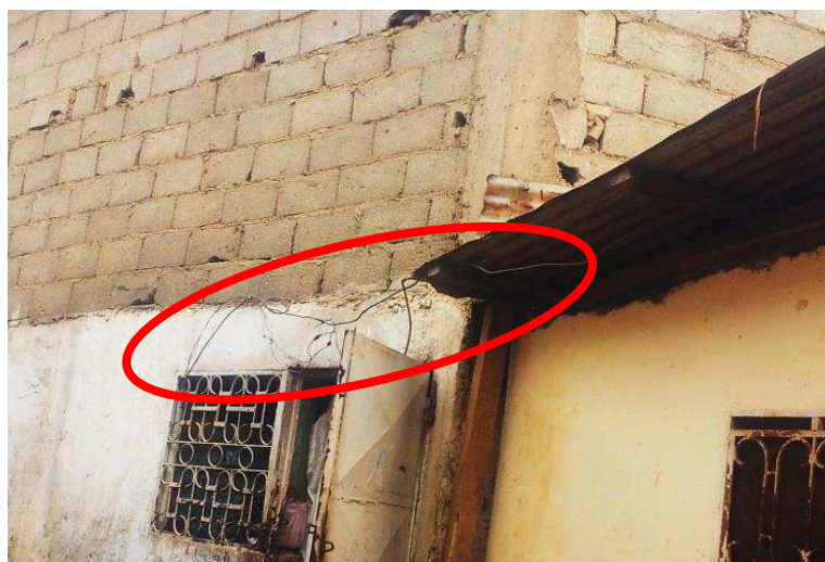
Photo 25 : Vue des câbles de distribution illégale de l'électricité à la Briqueterie
