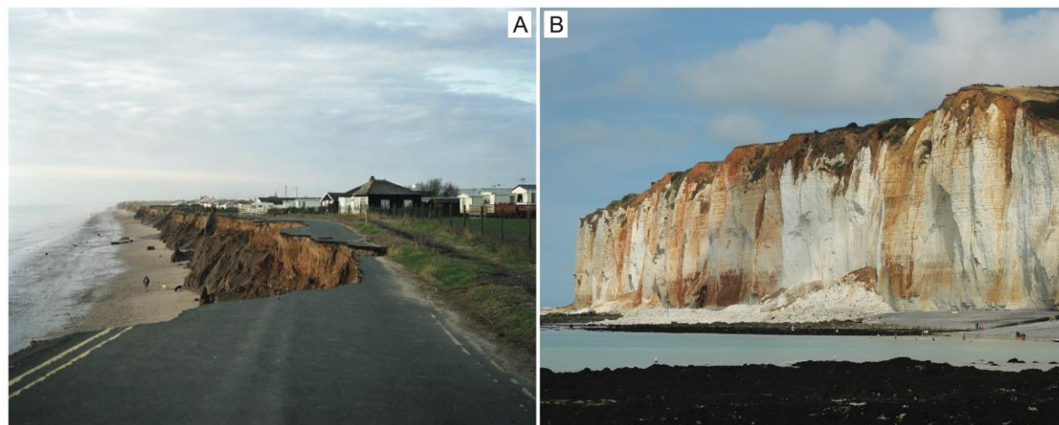
Figure 1.6 – (a) Effondrement de falaise affectant une route et un village sur les côtes de la Mer du Nord (Yorkshire) © N.A. White. (b) Effondrement de falaise des Petites-Dalles (Seine-Maritime) ayant eu lieu le 25 août 2016 à proximité de la plage.
