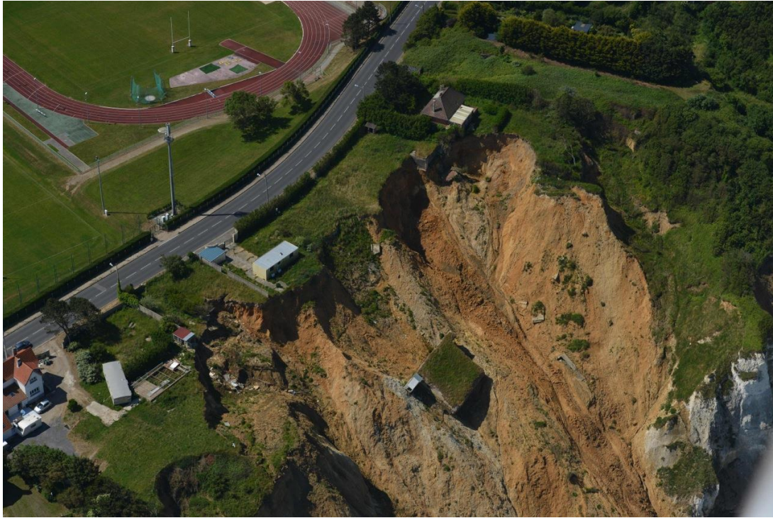
Figure 1.27 – Glissement de terrain affectant la falaise et les habitations entre Dieppe et Pourville © Ville de Dieppe.
