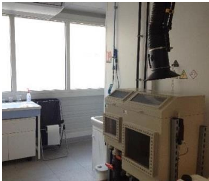
Figure II-2 : Cuves de traitement d'OMA et bras aspirant ATEX
