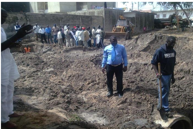
Photo 7 : Pose de tuyaux de drainage des eaux de pluies au quartier Léona Commune Yeumbeul-nord en février 2011 (Cliché : P. Diatta)
