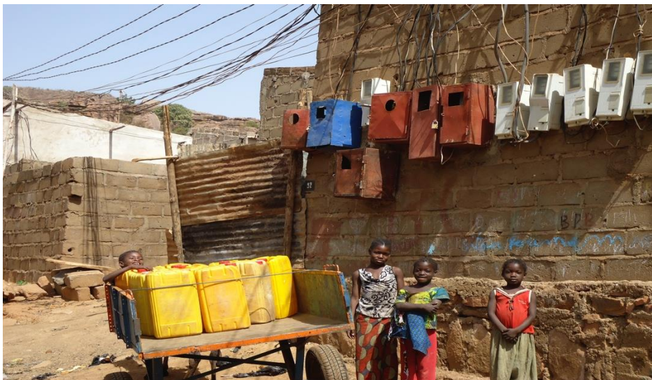
Photo 19 : Raccordement électrique clandestin au réseau électrique à Fadjiguila en janvier 2011 (Cliché : P. Diatta)
