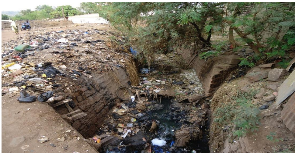
photo 43 : Egout bouché à Korofina Sud en Commune I à Bamako en janvier 2011 (Cliché : P. Diatta)
