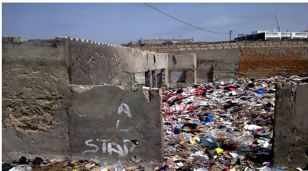
photo 42 : Maison en chantier transformé en dépôt sauvage par les habitants d'Aïnoumady à Yeumbeul en août 2012 (Cliché : P. Diatta)
