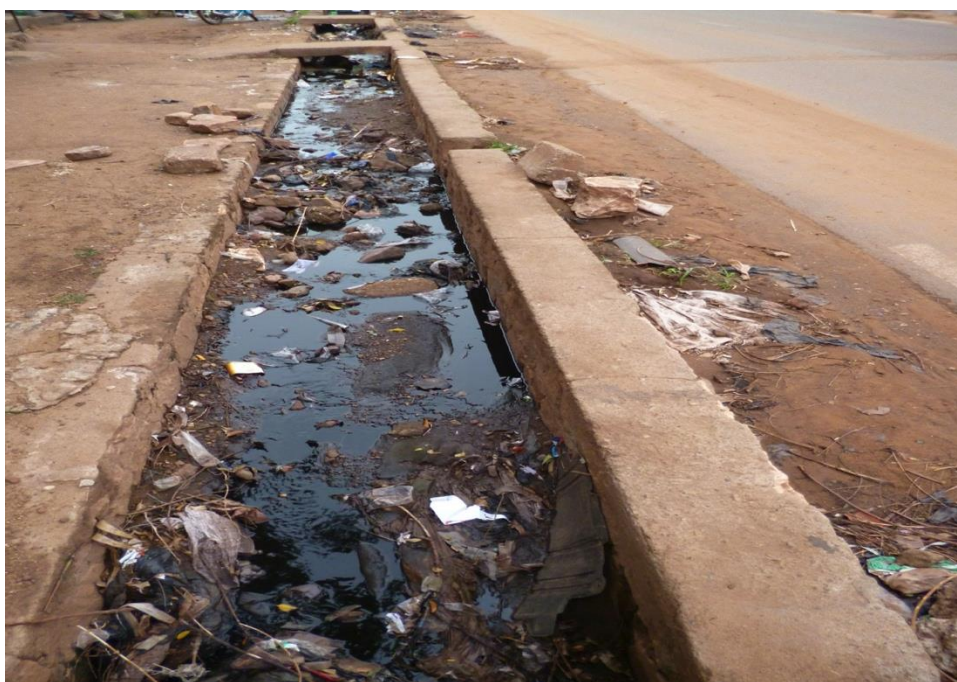
photo 44 : Egout à ciel ouvert obstrué par les ordures à 10 mètres de la mairie de Commune I à Korofina Nord en janvier 2011 (Cliché : P. Diatta)
