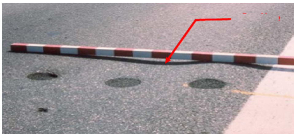
FIGURE 1.24: Photographie d'une ornière sur la chaussée (base documentaire IFSTTAR/MAST)
