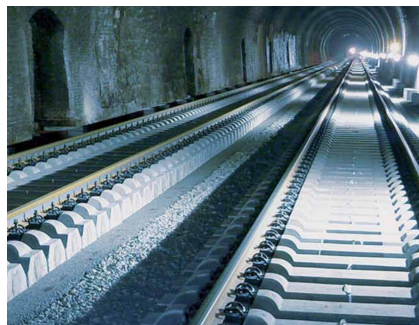
(b) Voie de type Getrac (PCM RAIL.ONE AG)
