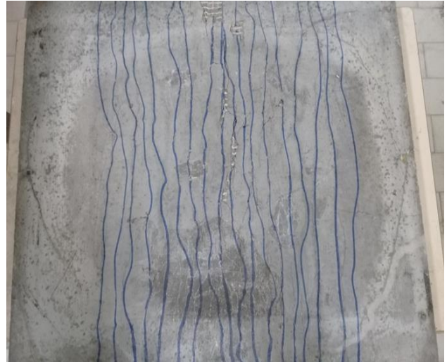
Comportement multifissurant et ductile dalle TRC de référence
