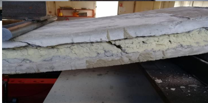
Rupture par cisaillement de l'ame du panneau TRC de référence
