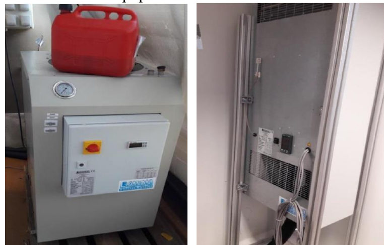
-1- Refroidisseur à eau glycolée
