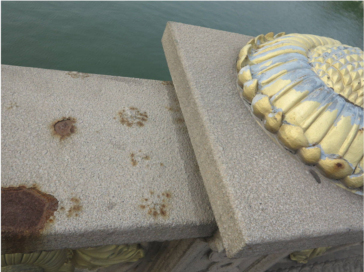
Figure 72 : Détériorations du Pont Daguang Ming de Tianjin.
