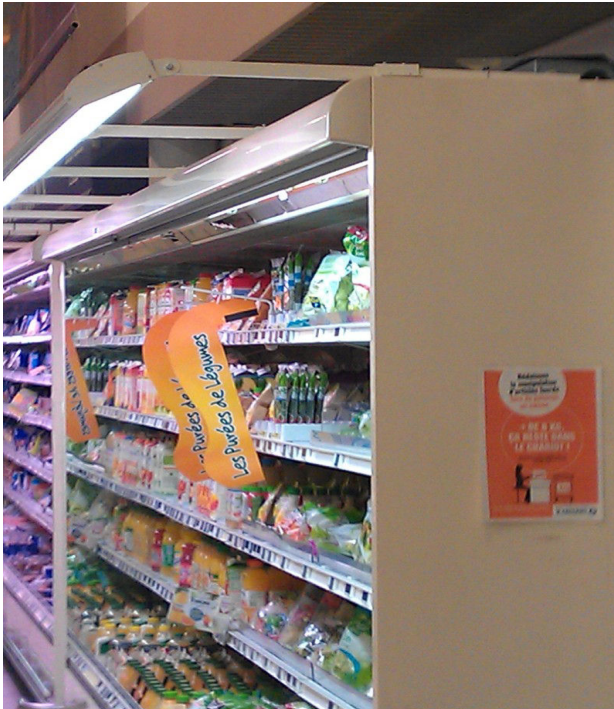
Figure 42: Vitrine réfrigérée à éclairage frontal, source: auteur
