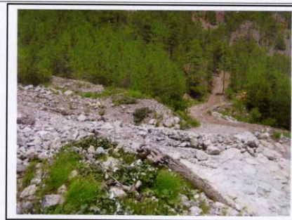
laissés de lave au niveau du radier
