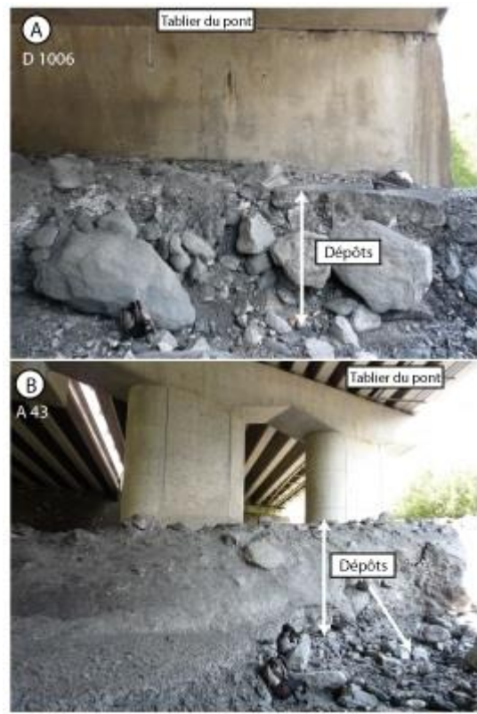
Figure 74. A. Engrèvement du lit torrentiel du Rieu Sec sous les ponts de la départementale D1006; B. Et de l'autoroute A43 (2011- sac à dos pour échelle)
