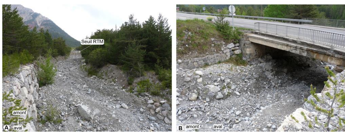
Figure 27. A. Chenal principal du torrent de Malefosse, vue en amont de l'ouvrage de franchissement routier, B. Chenal principal du torrent de Malefosse et ouvrage de franchissement de la route nationale N94 (pont à deux voies)
