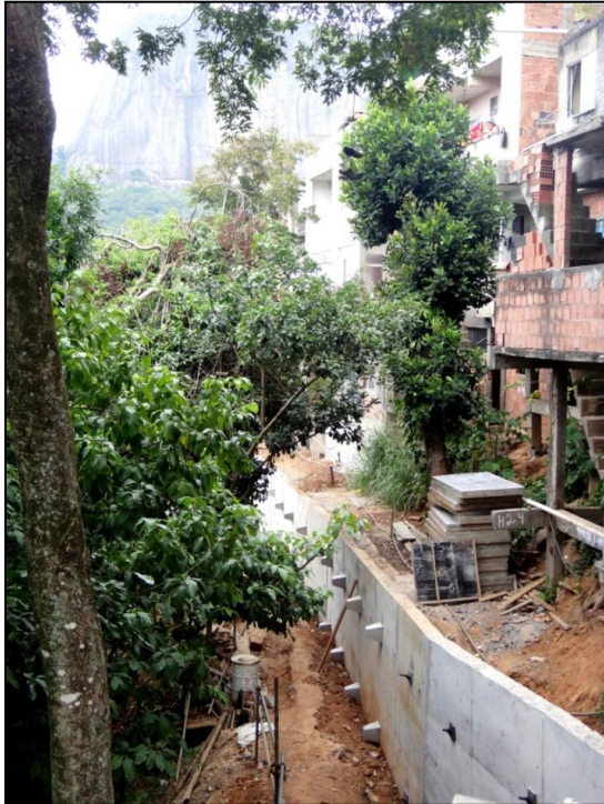
Photographie 69 : travaux de construction de murs de soutènement à Laboriaux à Rocinha
