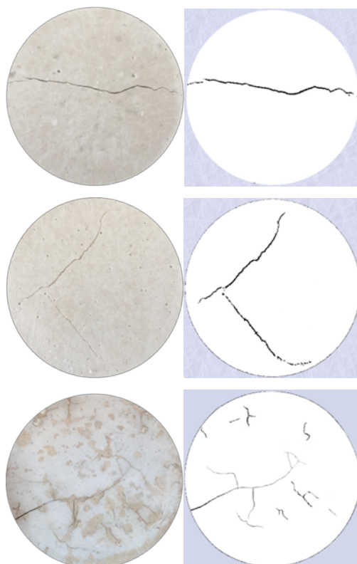
Figure 5 - 4 : Exemples de traitement d'images pour quantifier les dimensions et la fraction surfacique des fissures
