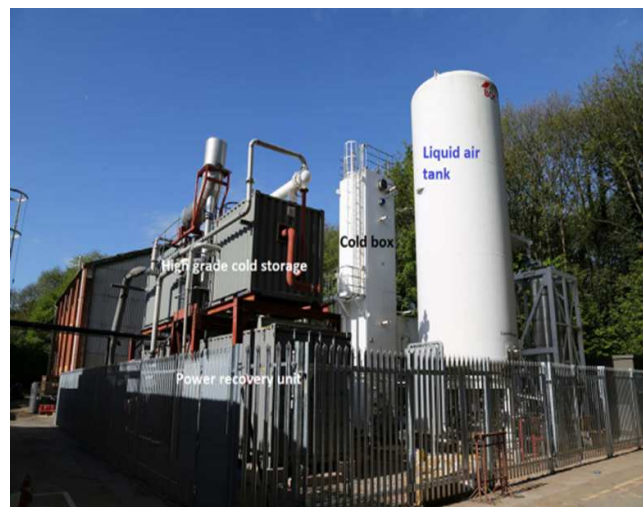
FIGURE 1.19 : Photo de l'installation pilote de stockage d'électricité par Air Liquide de Birmingham [14]
