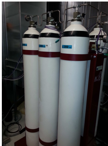
FIGURE 3.3 : Bouteilles sous pression de stockage d'air comprimé
