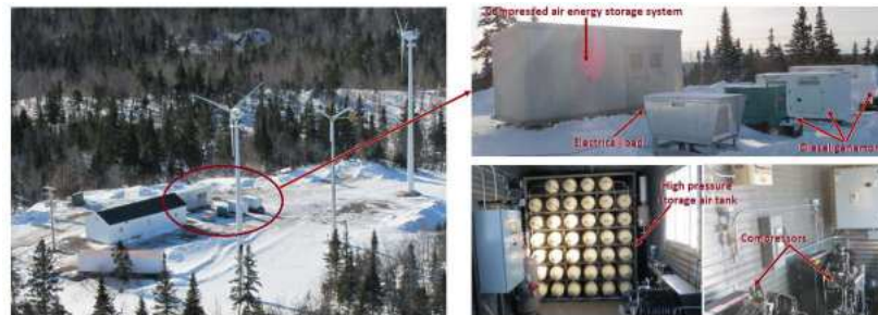
FIGURE 1.28 : Micro réseau expérimental utilisant le concept hybride éolien/diésel avec stockage d'air comprimé construit par TechnoCentre éolien au Canada [20]
