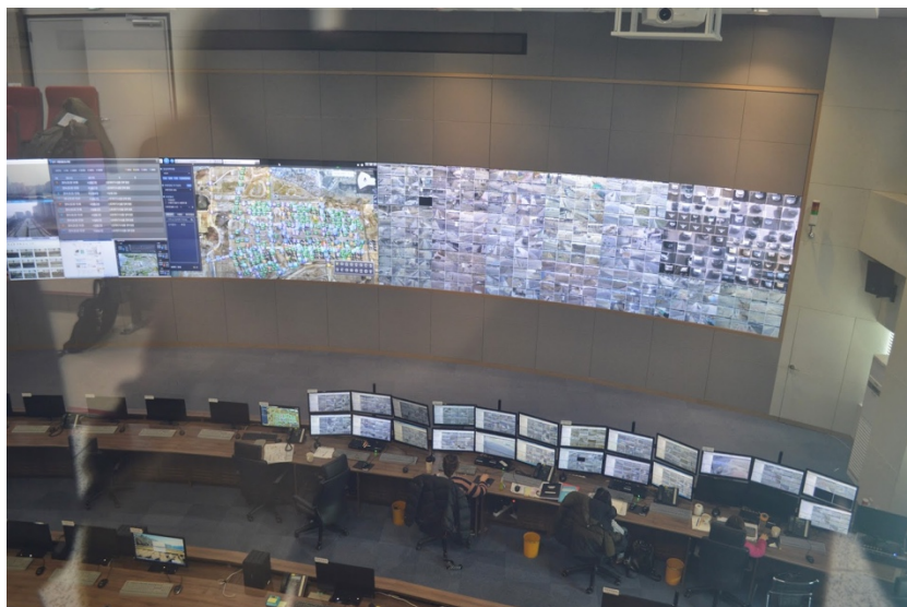
Figure 188 : Centre de contrôle de Songdo
