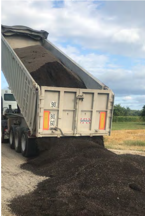
Figure V.19 Déversement des AE humidifiés en centrale
