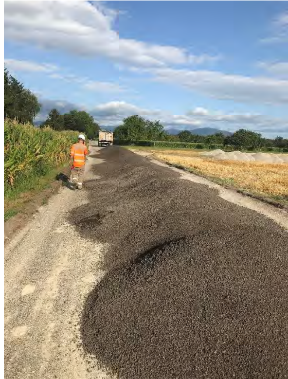
Figure V.20 AE déversés sur la chaussée
