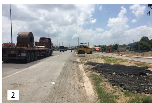
Un des derniers segments en construction de l'autoroute My Phuoc-Tân Van en direction de Biên Hoa (Đông Nai)
