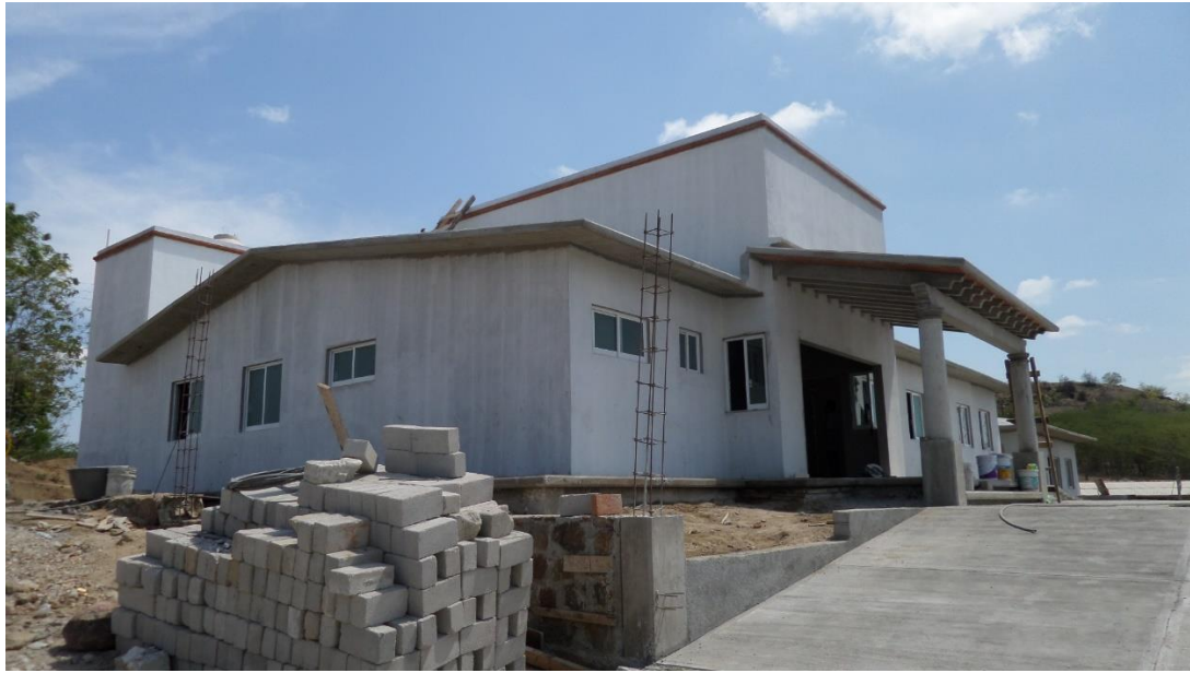
Figure 3. « Nouvelle » clinique de Lagunillas (construction interrompue)
