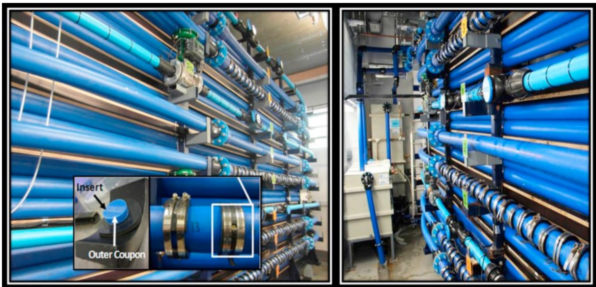
Figure 16 : Photographie de l'installation mimant un réseau de distribution d'eau potable de l'Université de Sheffield, Angleterre. La régulation de la température, de la concentration en chlore, de la pression et du flux d'eau permet de limiter des variations indésirables. Photographie issue de (Douterelo et al. 2018).
