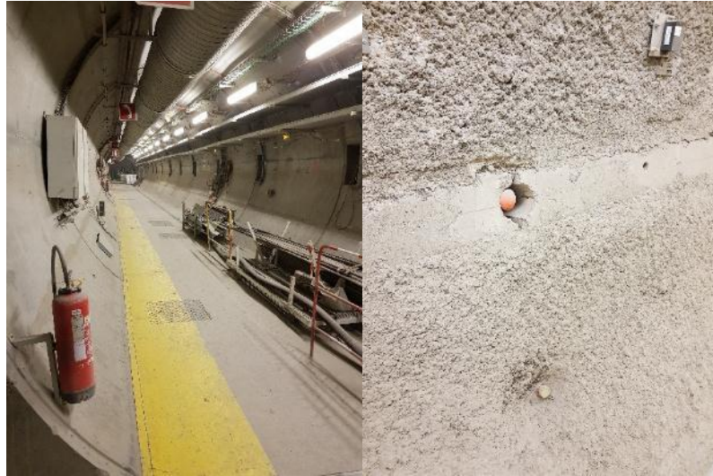
Figure III.4 : Photo de la galerie GCR (à gauche) et détail du soutènement en cales compressibles avec béton projeté (à droite)
