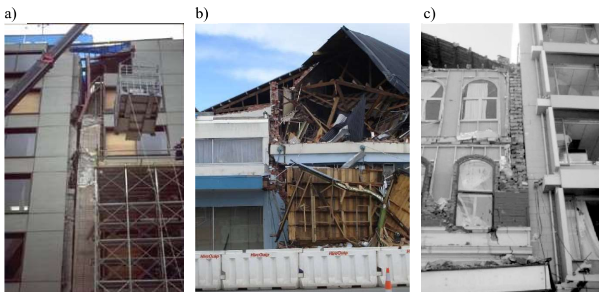
Figure 1.1 : Exemples de dommages aux structures provoqués par l'entrechoquement (a) [7], b) [9], c) [11]).
