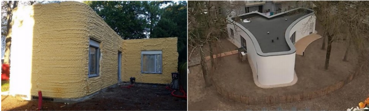
Figure 23 Réalisation de logements sociaux dans le cadre du projet BATIPRINT 3D (Furet, Poullain, & Garnier, 2019)
