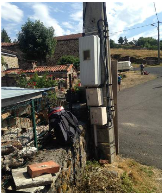
Fig. 54 — Le compteur sous la logette (en haut) directement raccordé au poteau électrique (Source : photographie personnelle, Montbonnet, Haute-Loire, 2015)
