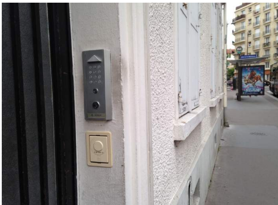
Fig. 60 — Boîtier de téléreport de compteur électronique sous le digicode d'un immeuble (Paris, 2017)
