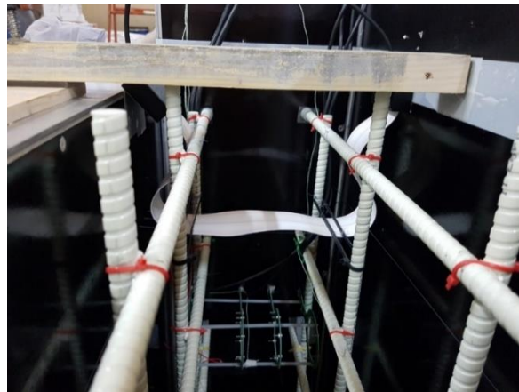
Figure 5-5 Vue des mailles d'armatures en fibre de verre (avant coulage) et du capteur TDR implémenté dans la dalle FV.
