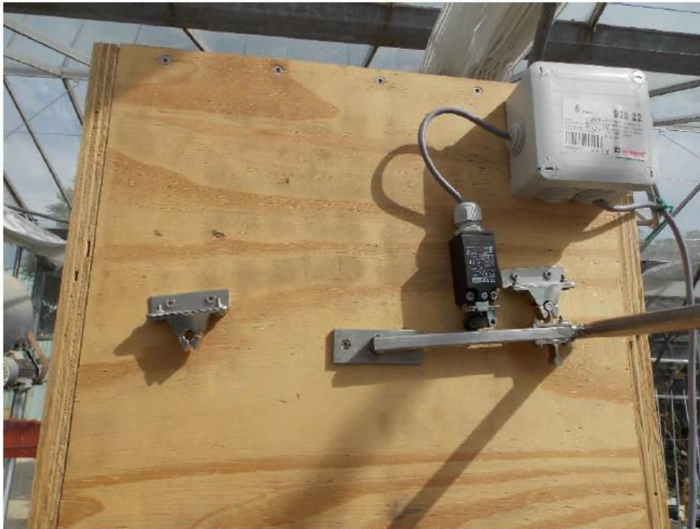
Figure 72 : Manivelle et loquets maintenant la position. On voit également le contact électrique de sécurité. (Photo : Frédéric Pascal, INRA PACA).
