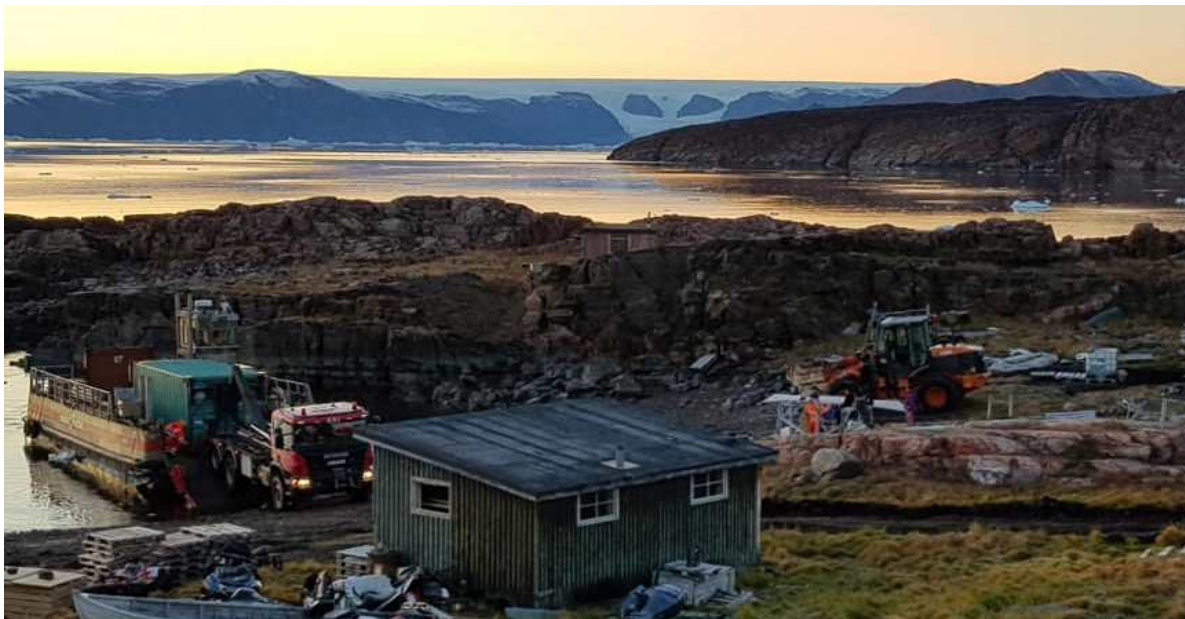
Figure 30 - Débarquement des engins de construction de la centrale électrique sur l'île de Qeqertat. 2018
