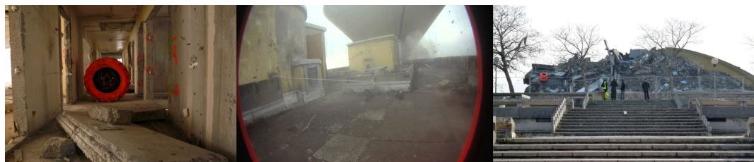
Figure 8. Anne-Valérie Gasc, Installation des 3 Crash Box et démolition de la tour Plein Ciel de Montreynaud/Saint-Étienne — 23/24 nov. 2011
