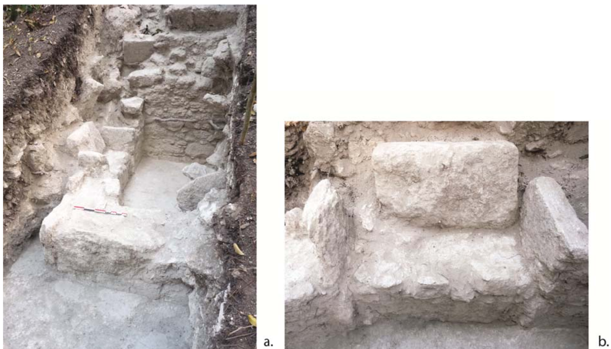
Figure 6.46 : vue depuis le Sud de l'angle sud-ouest de l'Edifice 60-5 Sud et de son accès occidental condamné (a.), ce dernier ayant peut-être été réaménagé comme une niche (b.) (Diaz 2013)
