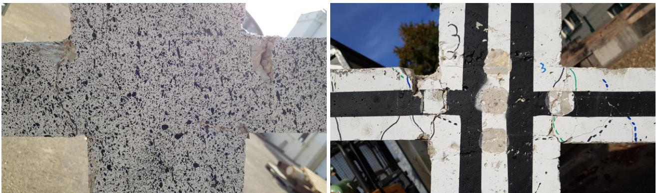
Figure 1.81 – Fissuration du pignon côté Y- (à gauche) et Y+ (à droite) à l'issue de l'ensemble des runs
