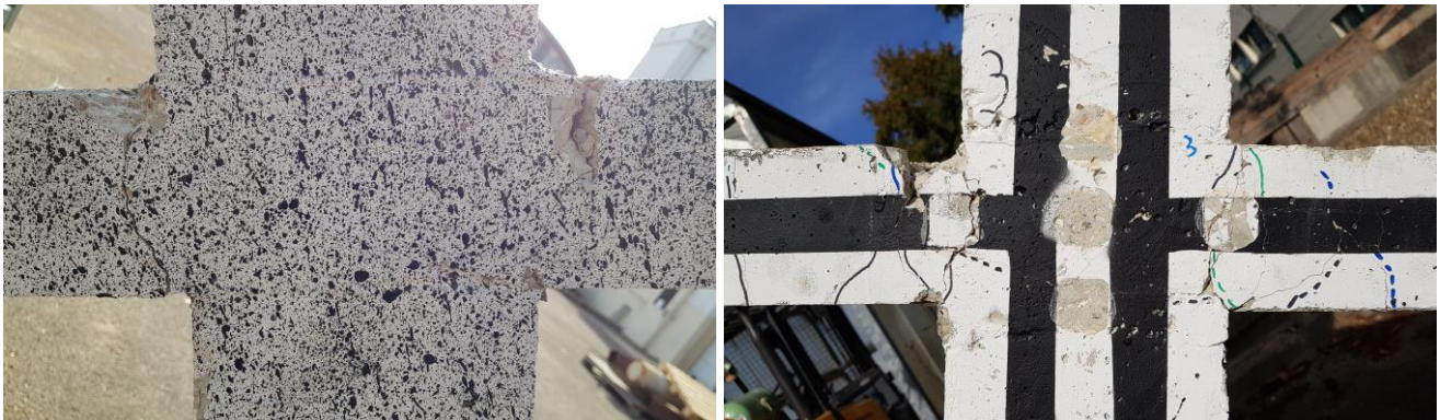
Figure 1.81 – Fissuration du pignon côté Y- (à gauche) et Y+ (à droite) à l'issue de l'ensemble des runs
